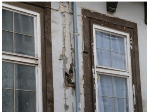
Abb. 55: Baufälliges Gebäude in der Worthstraße (links)
