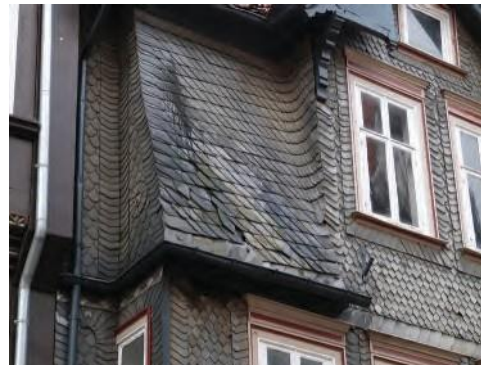
Abb. 57: Sanierungsbedürftiges Gebäude in der Straße Klappernhagen (links)
