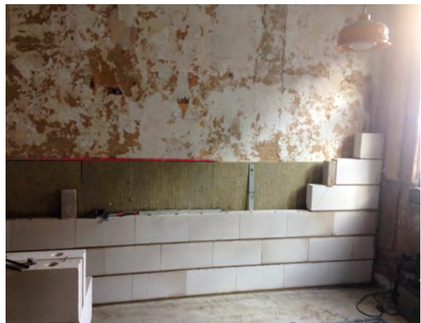
Bild 78 Einzug einer Brandwand zum Nachbargebäude
