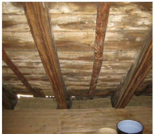
Bild 37 Unsanierter Dachstuhl mit Blick auf die Holzlattung
