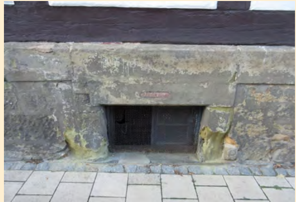
Bild 32 Feuchteschäden an einem unsanierten Sandsteinsockel (Baujahr: 1739)
