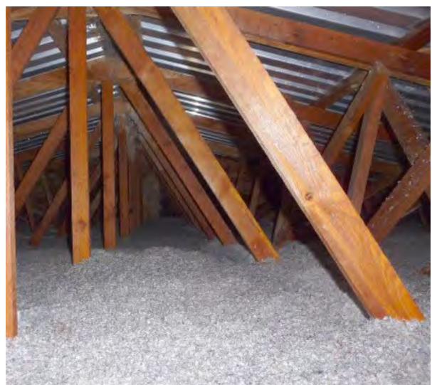
Bild 48 Lose Einblasdämmung auf der obersten Geschossdecke
