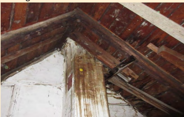
Bild 54 Versottung eines Kaminzugs
