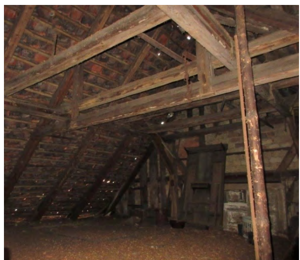
Bild 38 Unsanierter Dachstuhl mit Blick auf die Dacheindeckung von unten
