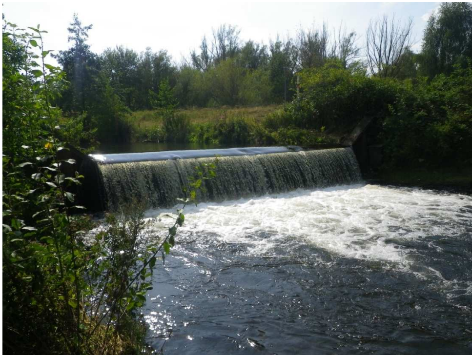
Abbildung 1: Sohlabsturz aus Stahlspundbohlenprofilen
